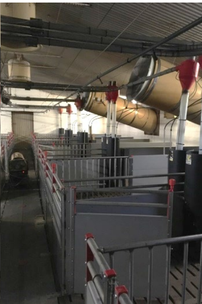
Figur 2. Placering af de to ventilationsrør, som ledte staldluften til luftrenseren.
